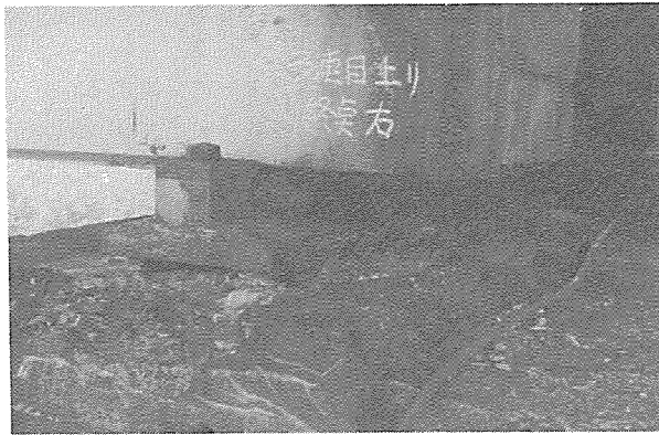
写真-Ⅲ.6 支承モルタルの欠落および残留しているライナープレート
