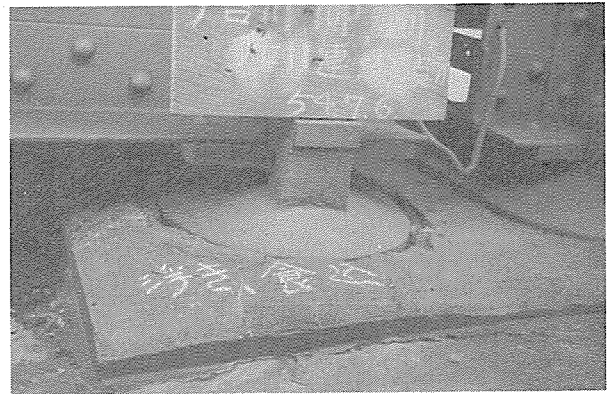
写真-Ⅲ.7 鋼桁シュアのシュア座モルタルへのめり込み
