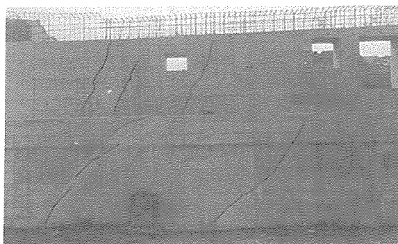
写真-4 ねじりモーメントにより斜めひびわれの発生した橋台
