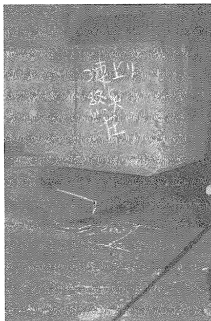
写真Ⅲ.4 破損した下シュー（チョーク個所で切損）
