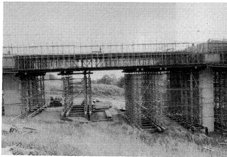
写真－3.2 はり支柱式支保工
