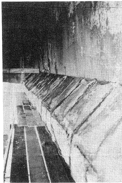
写真―10 かぶり不足による鉄筋の腐食
