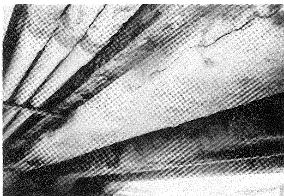
写真-11 モルタル吹付け部のひび割れ
