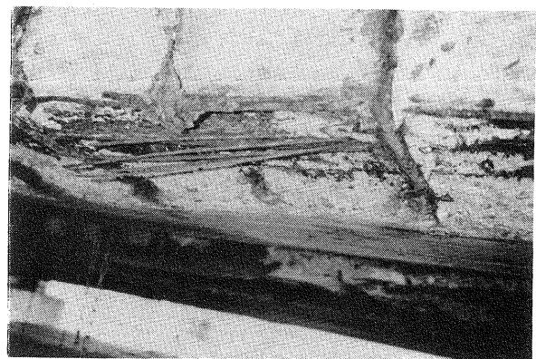
写真－７ ＰＣ鋼線の破断
