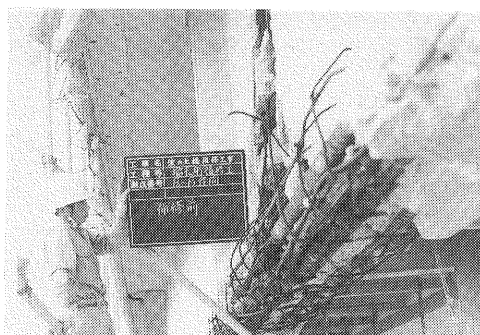
写真-7.2 被害桁下面
