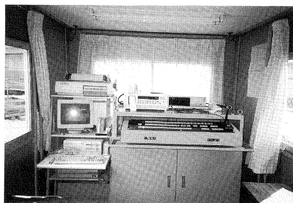
写真-8 押し出し作業制御室
