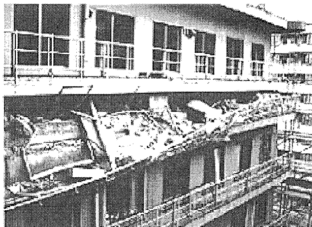
写真2 病院の5階に於ける中間層崩壊
