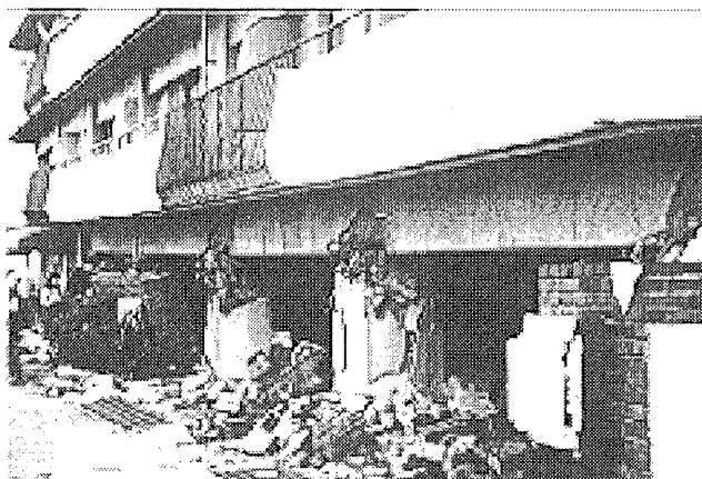
写真1 7階建て集合住宅の1階ピロティー部被害
