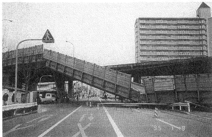
写真-3 瓦木西高架橋の被災状況
