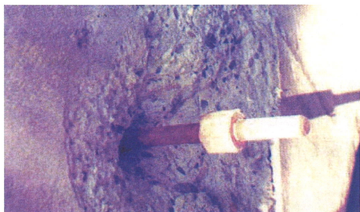
写真-2.4.1 PC鋼棒破断周辺の状況
