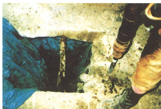
写真-2.2.2 PC鋼線の腐食および破断状況
