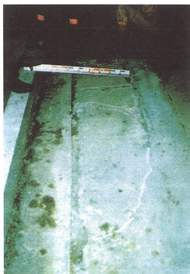
写真-2.2.1 間詰めコンクリート損傷状況
