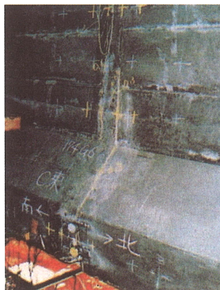
図-2.1.1 ブロック目地損傷状況
