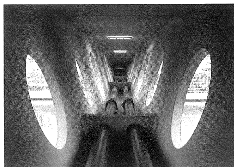
写真-16 桁内部の外ケーブル配置
