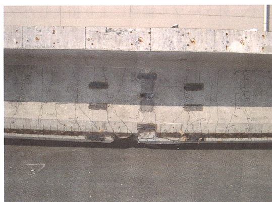
写真-7 実験終了後の支間中央部付近のひび割れ状況
