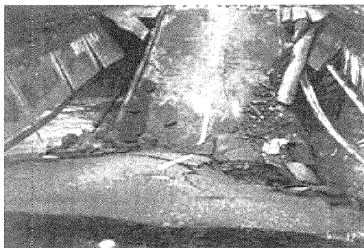
写真－6.1 Ynys-y-Gwas橋の落橋事故 4)
