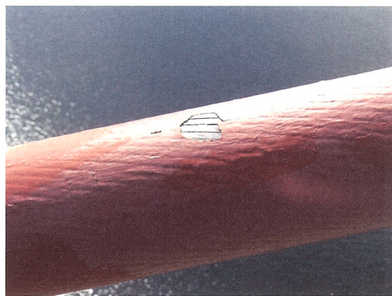
写真－2.14 斜材塗装の剥がれ
