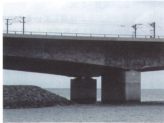
写真-2.23 ウェスト橋表面汚れ
