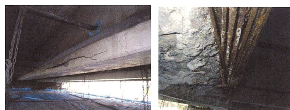
写真ー2.1 C橋の劣化状況(橋齢40年)
