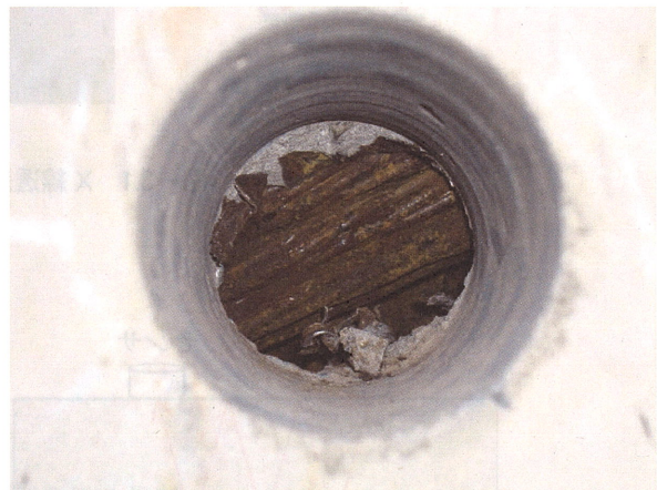
写真-3.1 削孔調査で確認されたグラウト充填不良例
