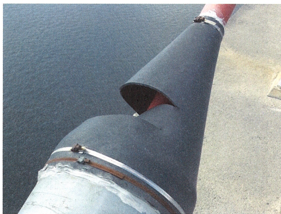
写真－2.13 止水カバーの破損
