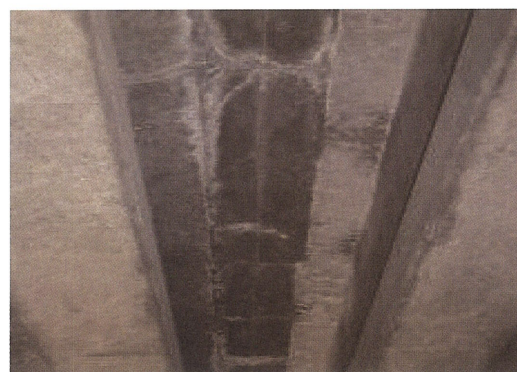
写真-2.1.1 T桁橋の間詰め床版の劣化
