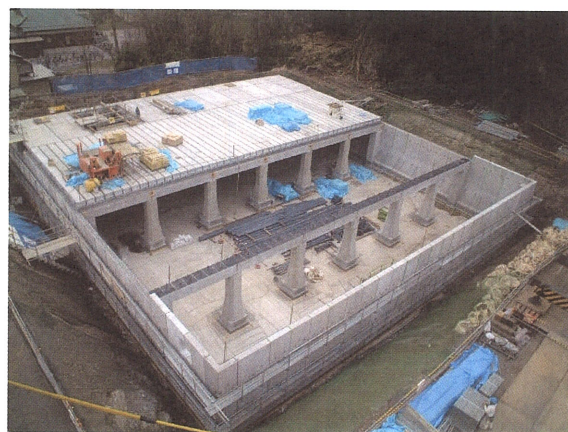
写真-5.15 雨水調整池
