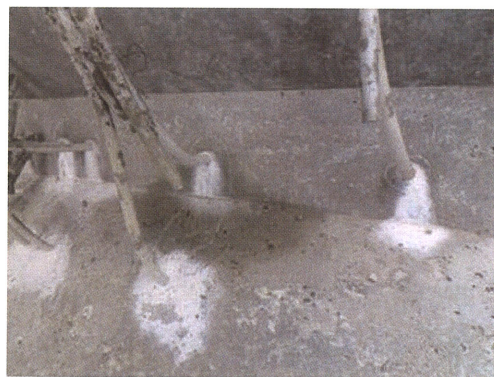
写真-2.2.7 グラウトホースの伝い水による漏水
