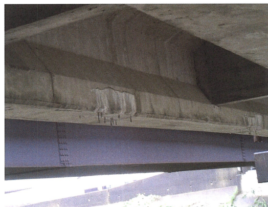
写真－2.2.9 主桁の損傷状況
