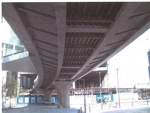
写真-3.4 高強度 PC 鋼材の適用事例（外ケーブル）
