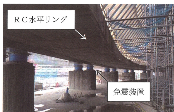
写真-5.4 柱頭の免震装置
