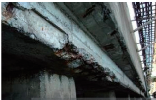
写真-2.2.1 東品川棧橋部の損傷状況
