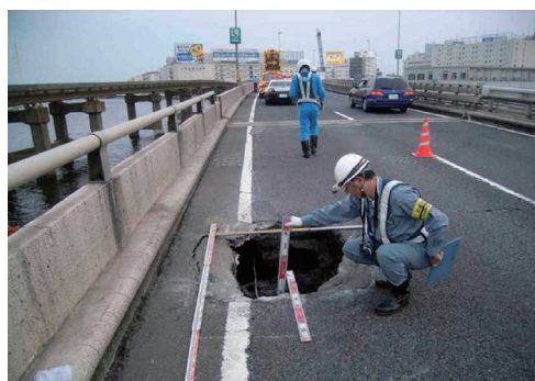
写真-2.2.2 鮫洲埋立部の損傷状況
