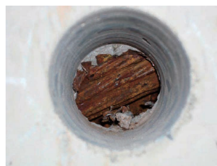
写真-5.1 削孔調査で確認されたグラウト充填不良例
