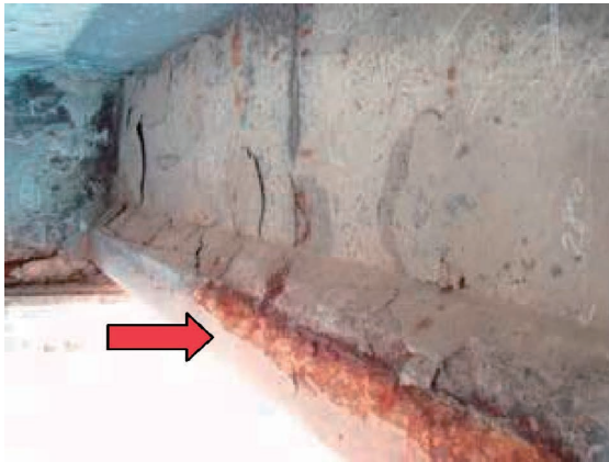
図-2.16 塩害劣化による変状発生例
