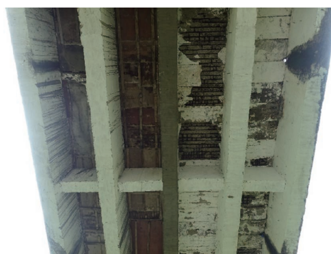
写真－1.1 劣化橋梁の例（ミャンマー）
