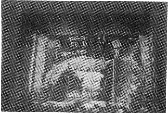
写真-1 S311横桁損傷
