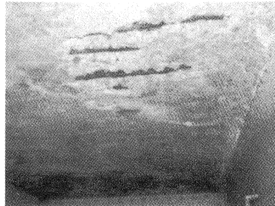
写真-3 中間床版部損傷状況
