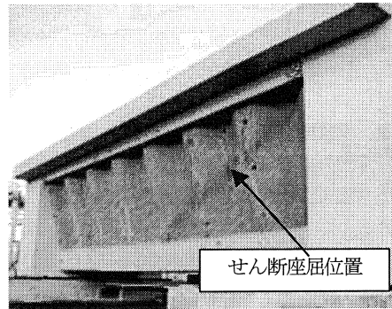
写真-2 せん断座屈状況
