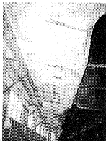
写真-4 施工前の損傷状況
