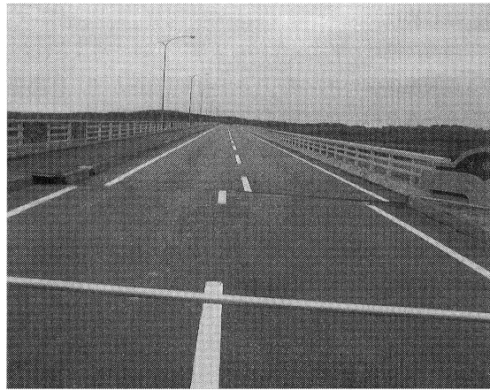
写真-1 主桁変位状況
