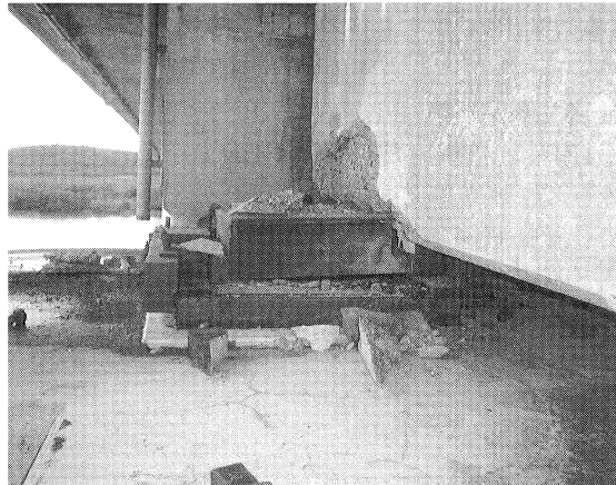
写真-2 支承損傷状況
