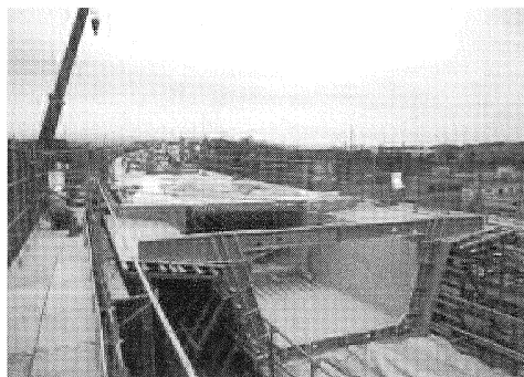
写真-1 移動式側型枠
