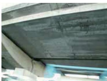
写真-2 橋軸方向のひび割れ
