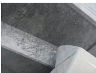
写真-3 亀甲状のひび割れ
