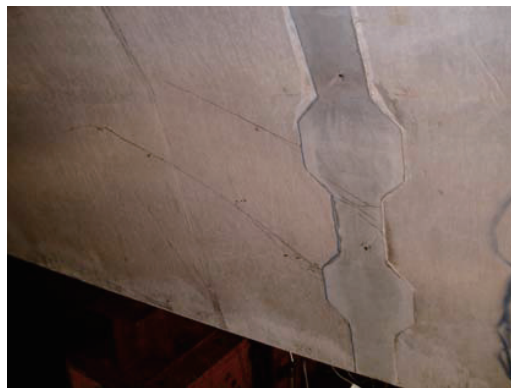
写真-2 クラック状況 (載荷後)
