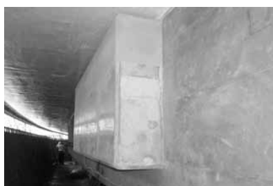
写真-4 定着突起 (ウェブ外側)
