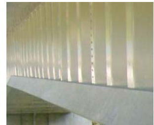
写真-1 ストラット下側接合部
