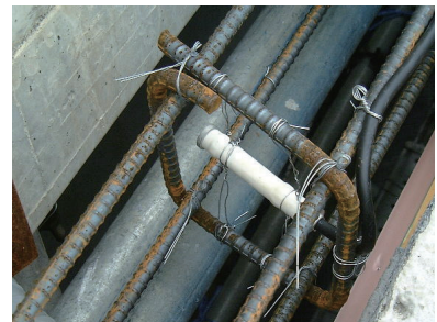
写真-1 埋込型ひずみ計(床版部)
