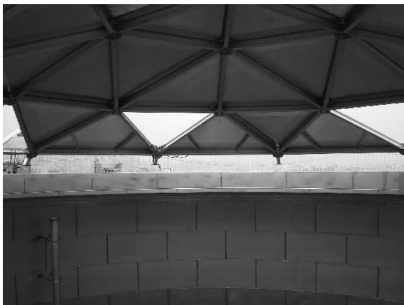
写真-1 ステンレス内貼りとアルミドーム
