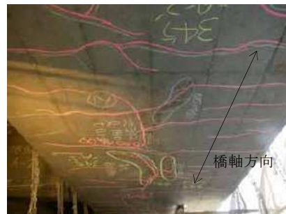
写真-3 ひび割れ状況
