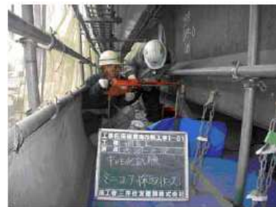
写真-4 中性化試験(コア)
