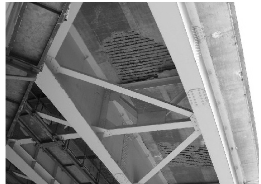
写真-1 床版下面の劣化状況
