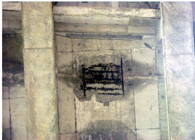
写真-2 凍結防止剤による床版の劣化
