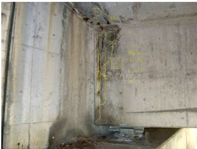
写真-1 凍結防止剤による桁端部の劣化
