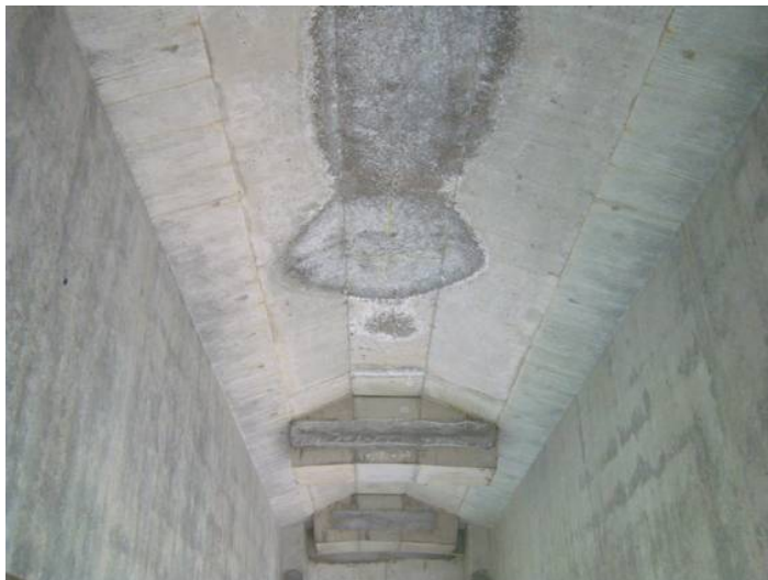
写真-3 水染みを生じた PC 合成桁の床版
