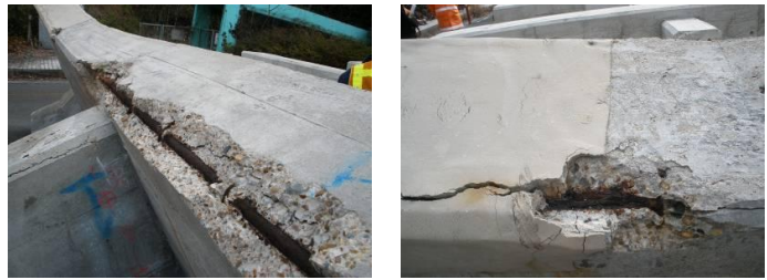
写真-2 腐食ひび割れの例
