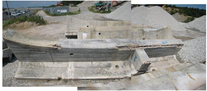
写真-1 塩害を受けた既設RC-T桁
