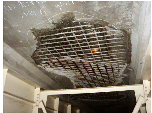
写真-1 床版下面の劣化状況
