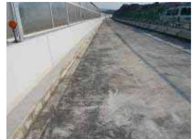
写真-4 残存するタックコートの状況
