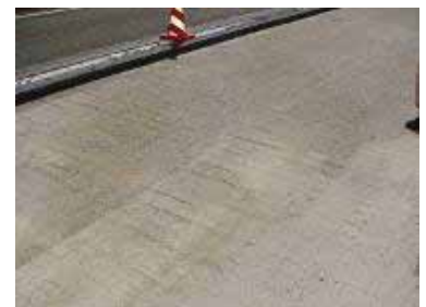
写真-6 床版面のひび割れ
