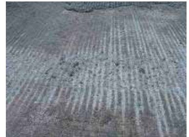
写真-3 床版切削による凹凸損傷
