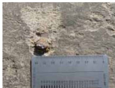
写真-5 段取鉄筋の露出
