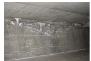
写真-5 PC鋼材に沿ったひび割れ(ウェブ内側)
