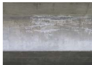
写真-4 PC鋼材に沿ったひび割れ(ウェブ外側)
