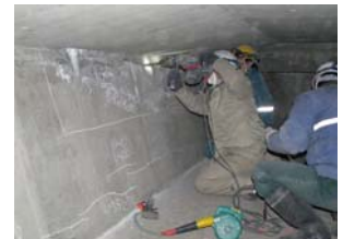
写真-6 PC鋼材に沿ったひび割れの内部陪調査
