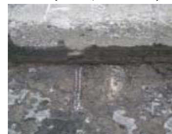
写真-14 上縁定着の後埋め部分(一部、鉄筋露出)
