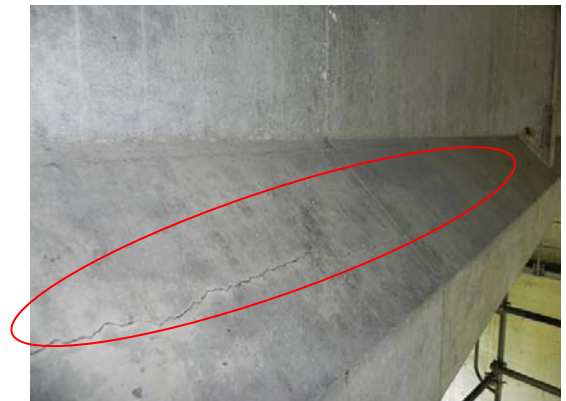
写真-2 ひび割れ状況
