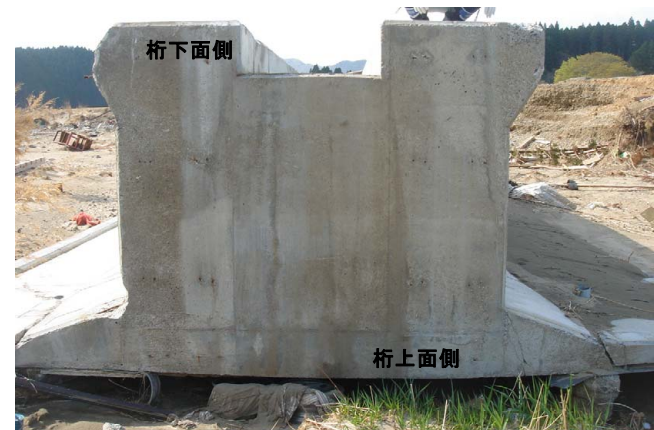
写真-8 上部構造断面Cの流出桁
