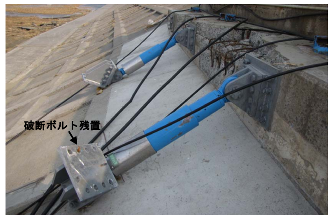
写真-4 右岸橋台側ダンパー
