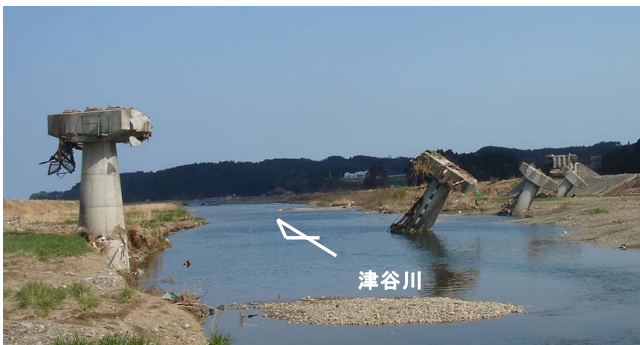
写真-5 P2, P3, P4 橋脚の柱傾斜
