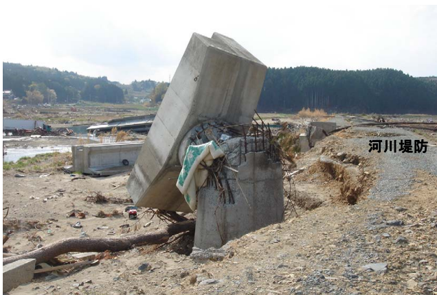
写真-6 P6 橋脚の梁傾斜
