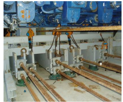
写真-4 橋軸地震時対抗装置
