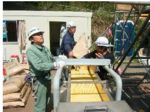
繊維投入用振動送風機による投入状況
