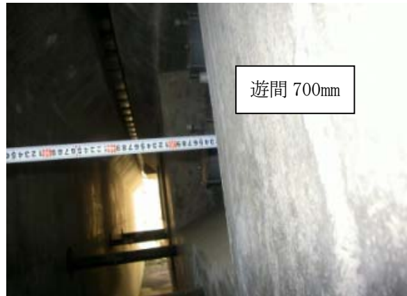
写真-1 桁端部遊間の状況
