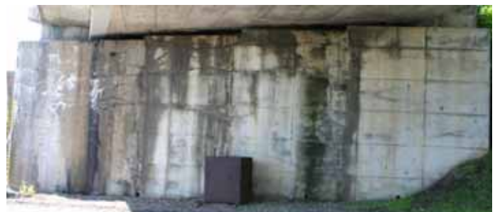
写真-1 橋台豎壁のひび割れ状況
