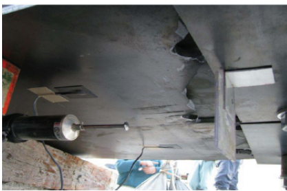
図-14 鋼板破断状況
