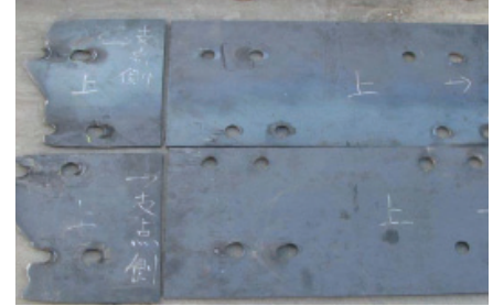
図-16 破断した鋼板
