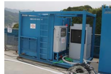
写真-2 水温コントロールユニット
