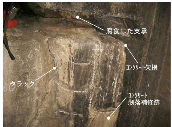
写真-2 ゲルバー部損傷状況(側面拡大図)
