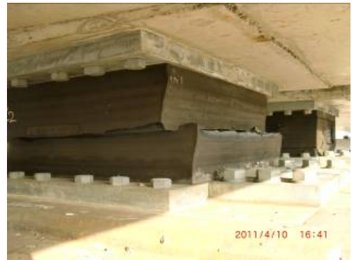
写真-1 ゴム支承（破断）
