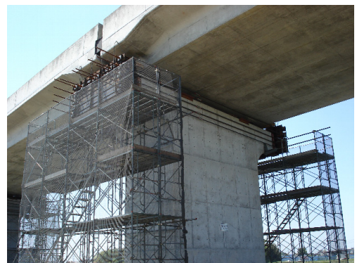
写真-3 鋼製変位制限装置
