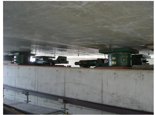
写真-4 位置修正用ジャッキ
