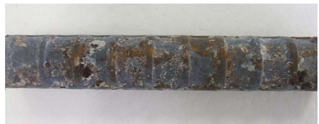
写真-1 無通电部の鉄筋状態
