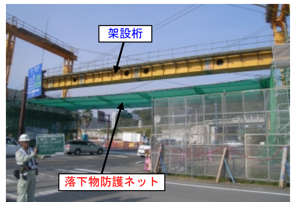
写真-2 県道への落下物防護ネット
