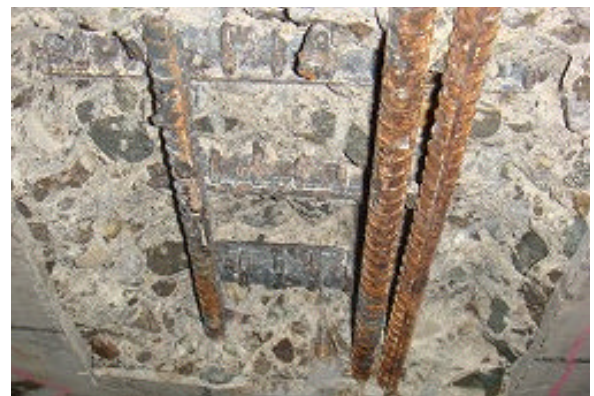
写真-1 RC中空床版橋の鉄筋腐食状況
