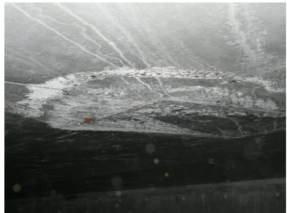
写真-4 ポットホールAの上床版下面の状況
