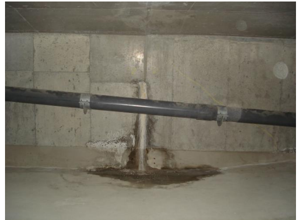
写真-1 箱桁内部の漏水
