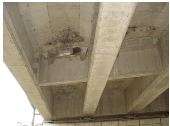
写真-2 一次、二次床版の継目の漏水
