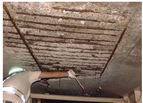
写真-1 劣化状況
