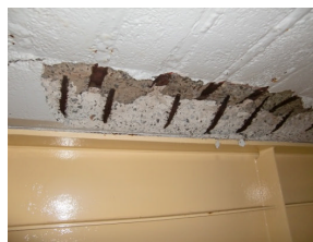
写真-2 床版下面損傷状況
