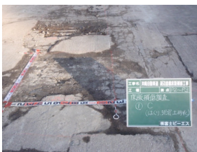
写真-1 床版上面損傷状況
