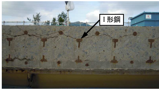
(c) 上縁側鉄筋と I 形鋼上縁に沿ったひび割れ
