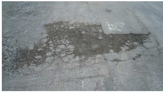
(a) 床版上面の土砂化
